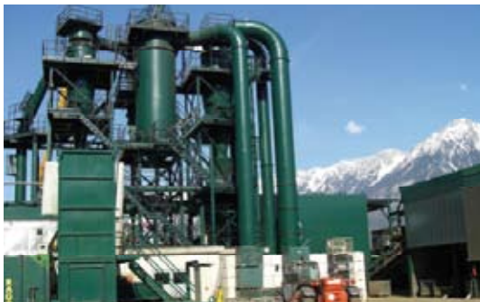
SHREDDERANLAGE (TSG TIROL)
